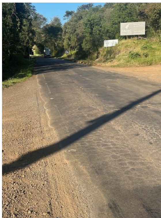
18 – Afundamento e recalque na pista – 165,80
