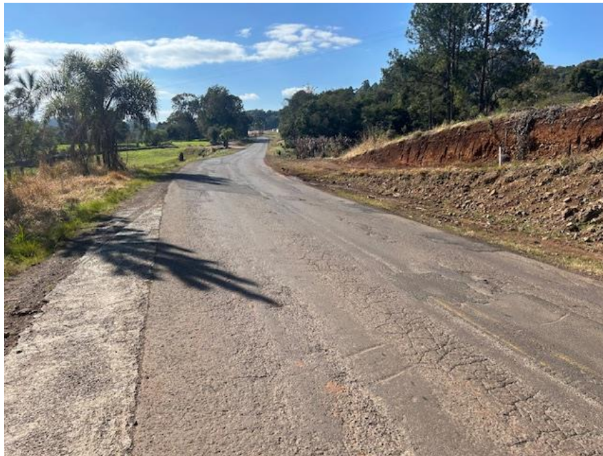
2 – Desagregação do pavimento – km 2,80
