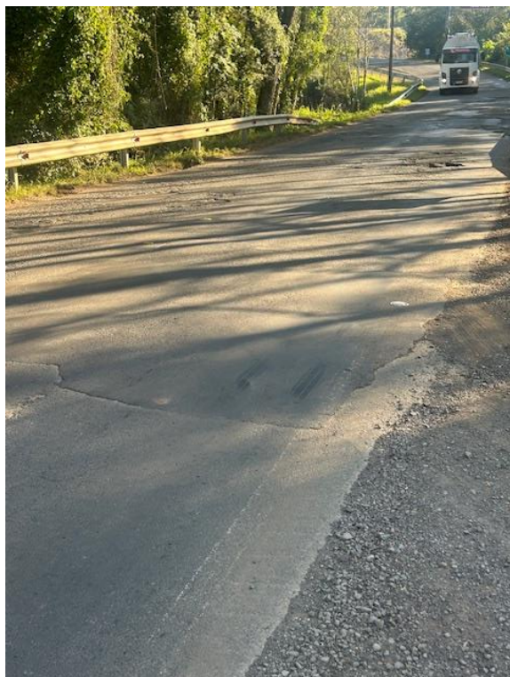
17 – Situação do pavimento no km 165,50
