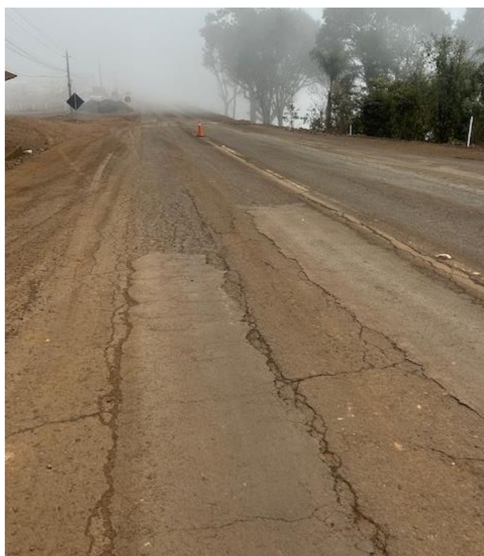
28 – Desagregação do pavimento no km 59,00
