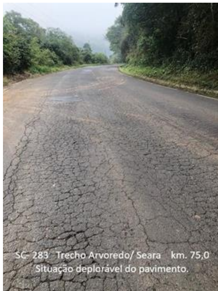
22 – Situação do pavimento no km 75 no ano de 2021
