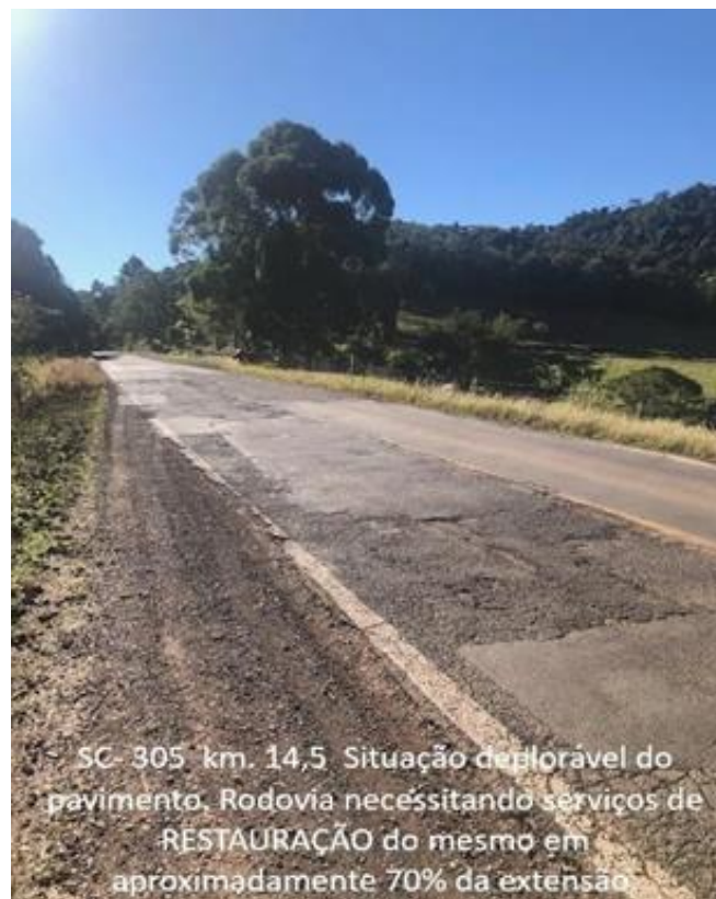
7 – Situação do pavimento no km 14,5 no ano de 2021
