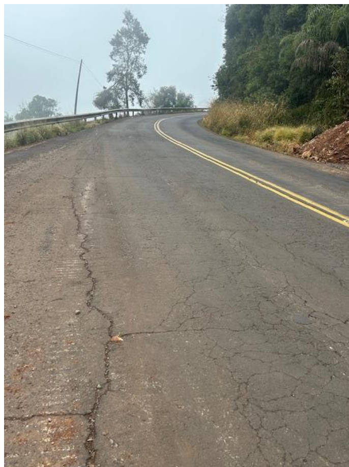
27 – Situação do pavimento no km 60,30
