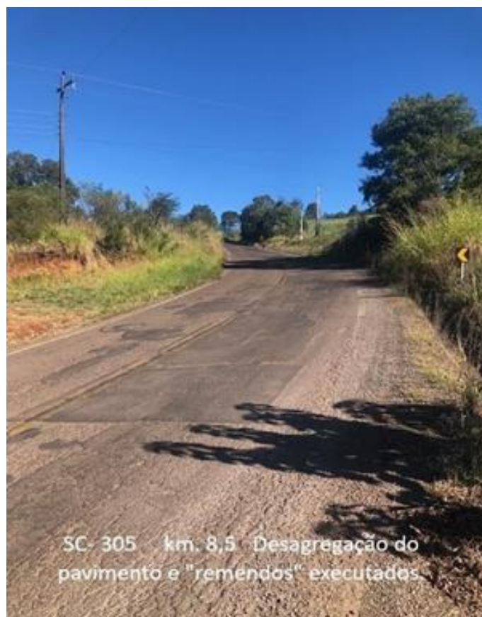
4 – Situação do pavimento no km 8,5 no ano de 2021
