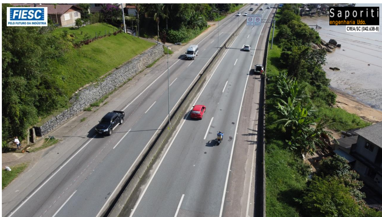
1: Km 192- Buracos na pista
