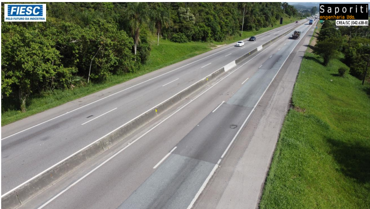
2: Km 184 - Buracos na pista e necessidade de rejuvenescimento do pavimento com micro revestimento
