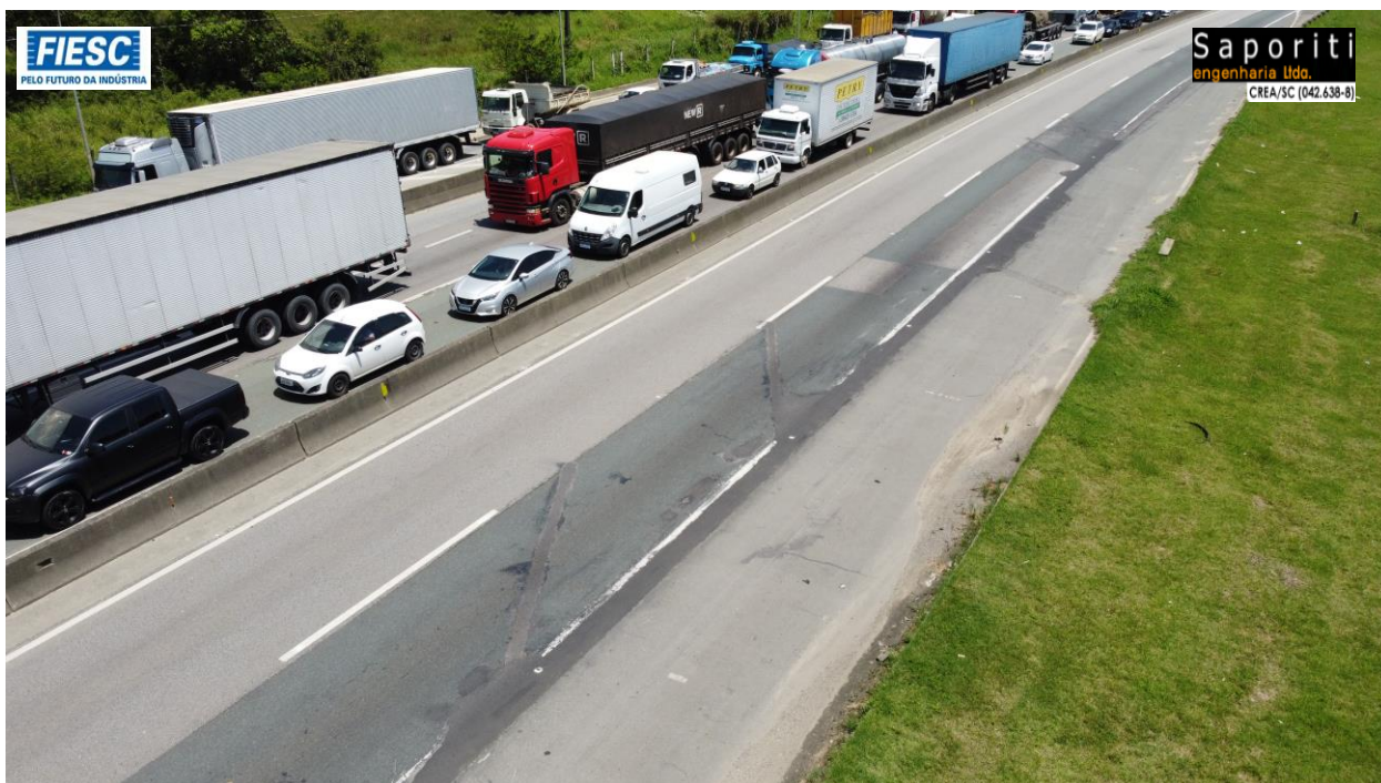
4: Desagregação do pavimento no km 102
