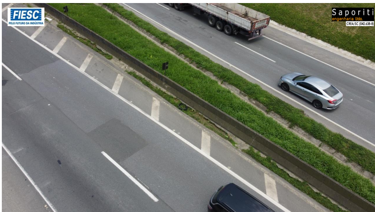
5: Km 52,8 - Recomposição de grelhas de drenagens quebradas - Situação se repete em vários outros locais
