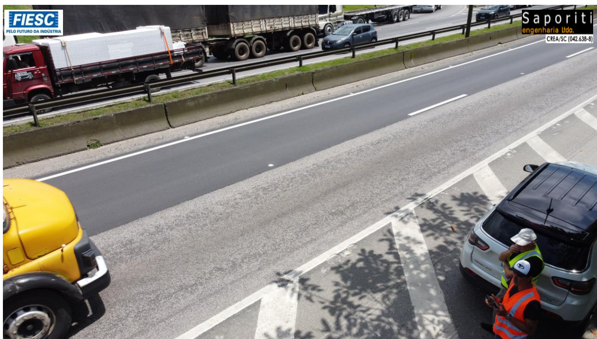
3: Trincamento do pavimento na interseção das BRs 101 e 470 - Necessidade de micro revestimento contínuo
