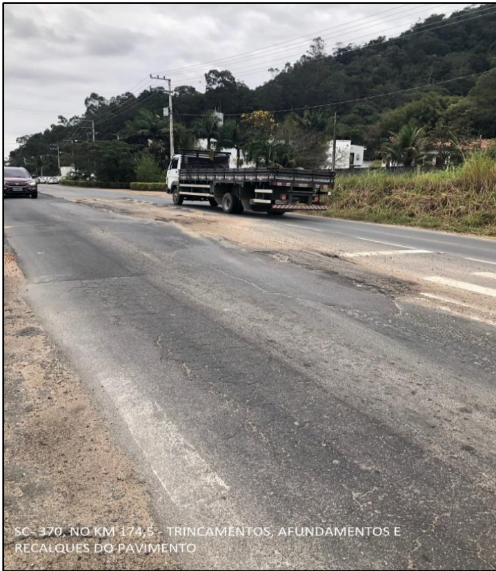
SC-370 – KM 174,5 Trincamentos, afundamentos e recalques do pavimento
