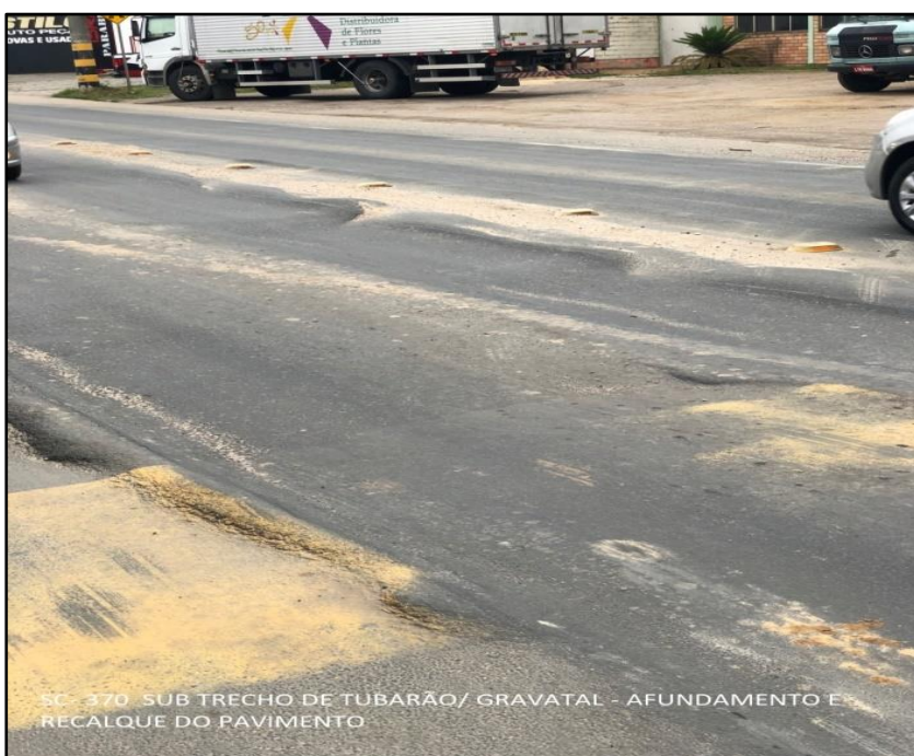
SC-370 – sub trecho de Tubarão/Gravatal Afundamento e recalque do pavimento
