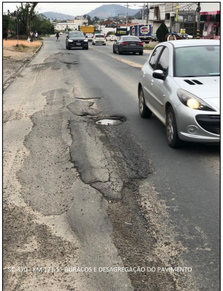
SC-370 – KM 171,5 – Buracos e desagregação do pavimento
