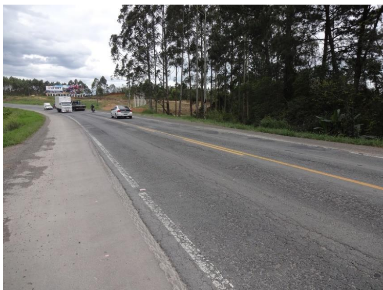
Ilustração 24: Trincamento e desagregação do pavimento
