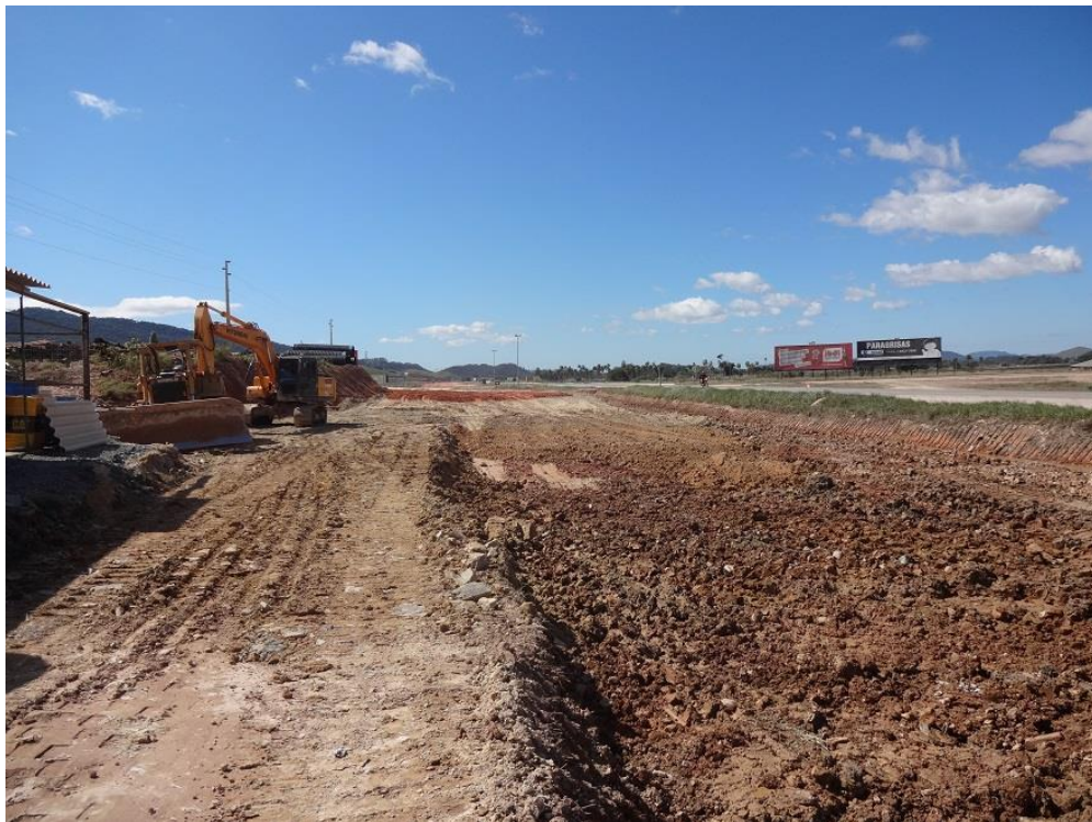
Ilustração 15: Remoção de solos moles, de baixa capacidade de suporte, e substituição por areia ou pedra detonada
