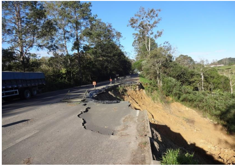
Ilustração 25: Erosão, em aterro, no km 169
