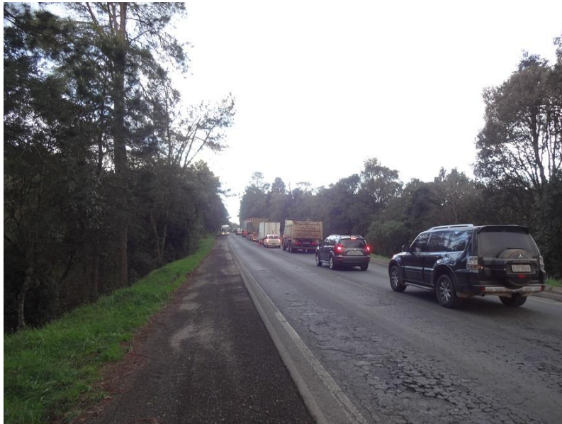
Ilustração 28: Km 225,0 - Situação do pavimento
