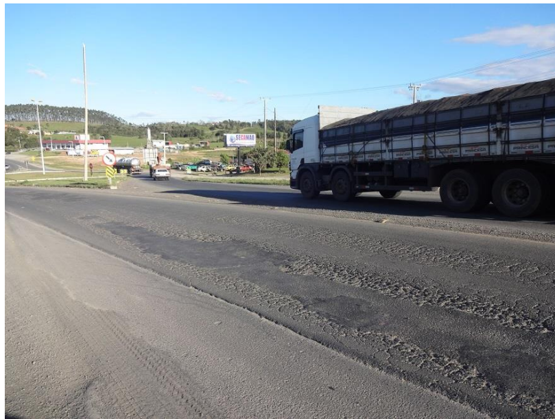
Ilustração 26: Situação do pavimento no km 178- Acesso a Taió
